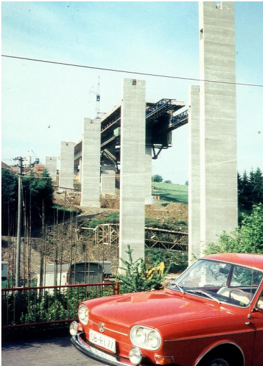
Historische Aufnahme aus den frühen 1970er Jahren mit Blick auf die Fertigstellung der Fahrbahn über den Pfeilern der Loopetalbrücke.
