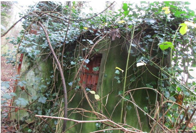
Überwucherte Reste des früheren Eingangsportals zum ehemaligen jüdischen Friedhof "am Kasselbach" in Remagen-Rolandseck (2015).
