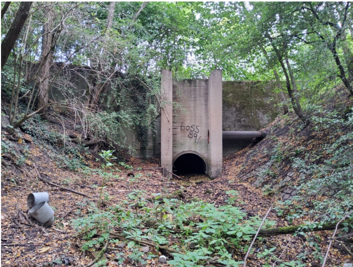
Kraftwerk Muldenstein - Entwässerung Kraftwerk Fotograf/Urheber: NAME FEHLT
