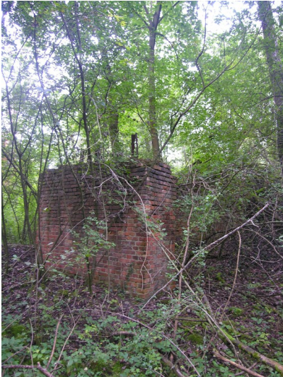
Bahndamm mit sogenannter "Tonbrücke" (1936-1960) - Pfeilern und Stützmauern der "Tonbrücke"; Bloick S Fotograf/Urheber: NAME FEHLT
