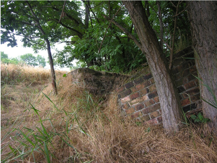
Albertschacht mit Tagesanlagen und Seilbahnstation - Mauerwerk und Fundamentreste; Blick NW Fotograf/Urheber: NAME FEHLT
