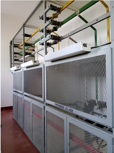
Techniksammlung Stadtwerke Halle - Sammelschienen Fotograf/Urheber: NAME FEHLT
