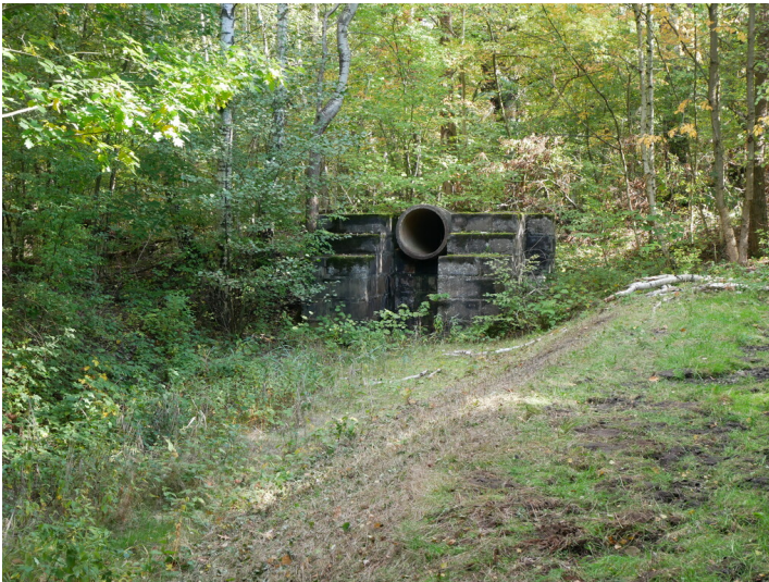
Überlaufbauwerk Fotograf/Urheber: Franz Dietzmann
