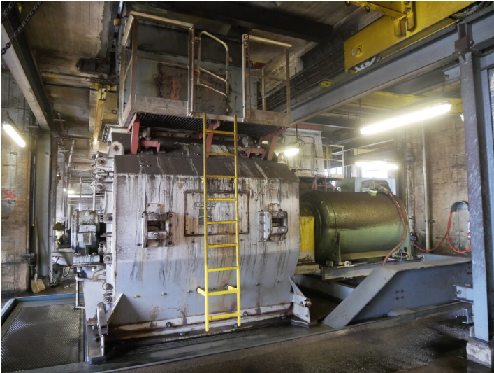
Hammermühlen Vorbrecher Fotograf/Urheber: Tanja Trittel
