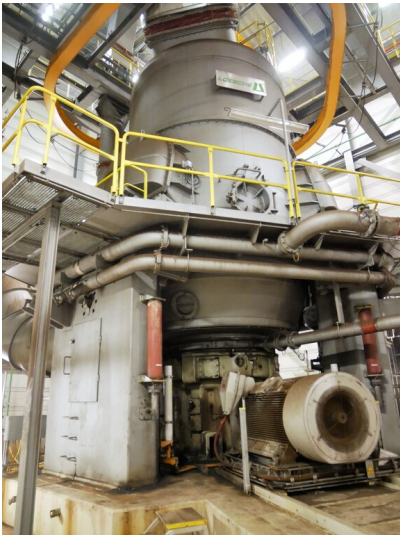
Braunkohlestaubmahanlagen Fotograf/Urheber: Kaja Boelcke
