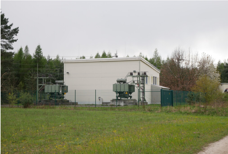
Gleichrichterstation II Fotograf/Urheber: Franz Dietzmann
