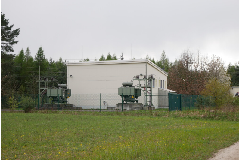
Gleichrichterstation II Fotograf/Urheber: Franz Dietzmann
