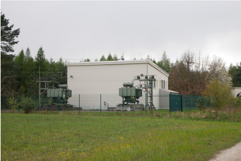
Gleichrichterstation II Fotograf/Urheber: Franz Dietzmann
