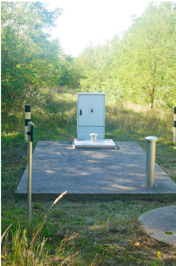
Enteisungsanlage für Steinitzer Quellgebiet Fotograf/Urheber: Dr. Barbara Kündiger
