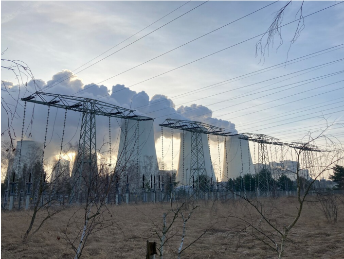
Freileitung Kraftwerk Jänschwalde Fotograf/Urheber: Tanja Trittel
