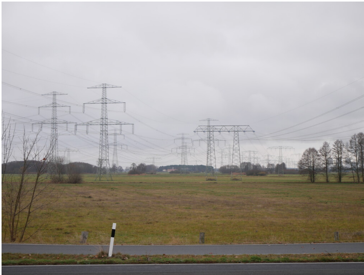
380 kV Freileitung Kraftwerk Jänschwalde (2021) Fotograf/Urheber: Franz Dietzmann
