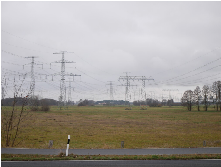
380 kV Freileitung Kraftwerk Jänschwalde (2021) Fotograf/Urheber: Franz Dietzmann
