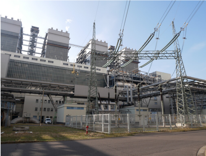
Kraftwerk Jämschwalde Blocktransformators (2023) Fotograf/Urheber: Tanja Trittel
