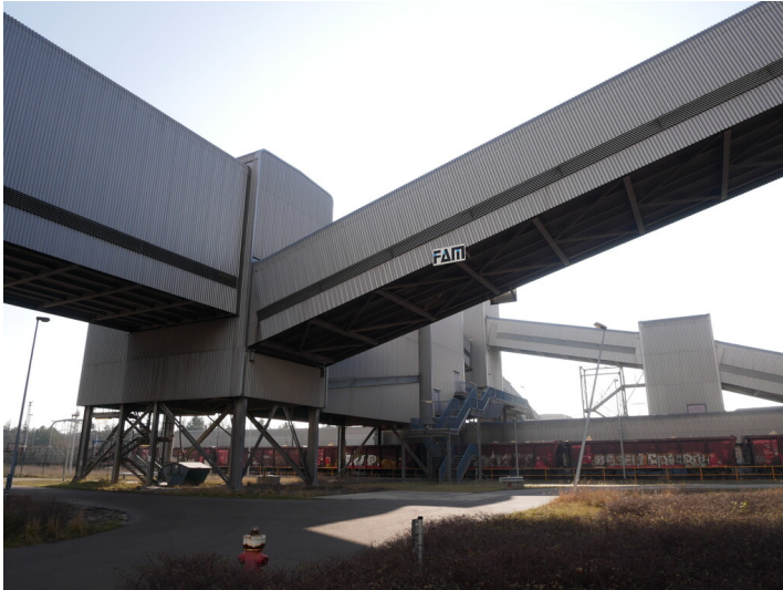
Kraftwerk Jänschwalde Förderbandanlage (2023) Fotograf/Urheber: Tanja Trittel
