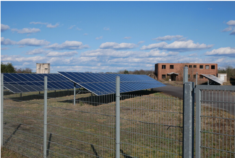
Solarpark Pritzen Fotograf/Urheber: Franz Dietzmann
