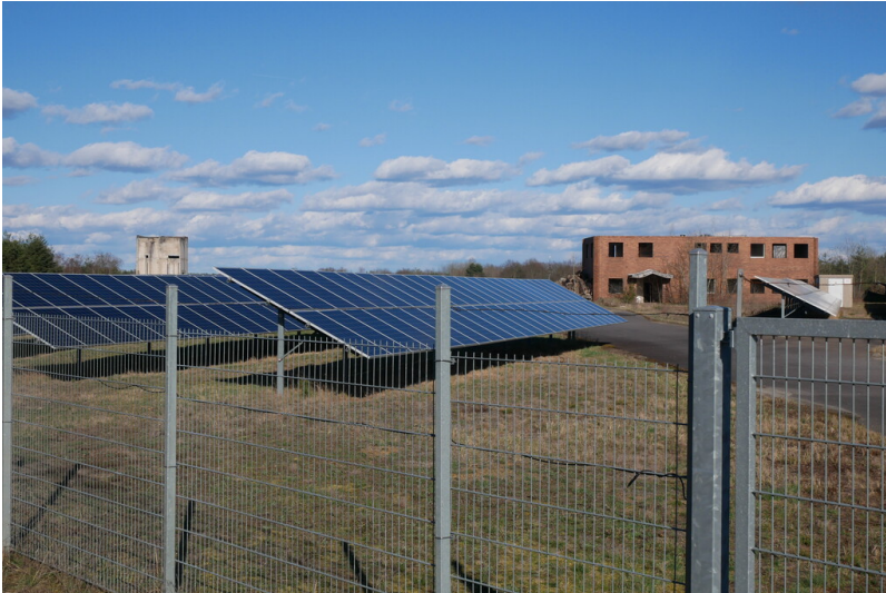
Solarpark Pritzen Fotograf/Urheber: Franz Dietzmann
