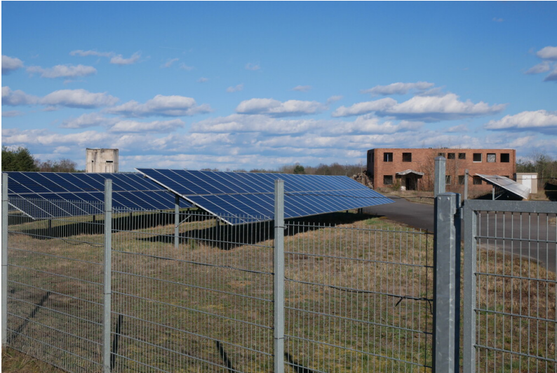
Solarpark Pritzen Fotograf/Urheber: Franz Dietzmann
