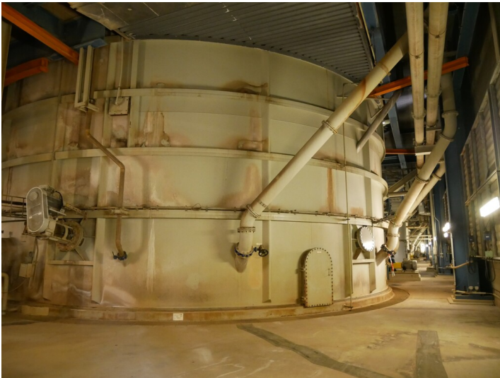
Kraftwerk Jänschwalde REA-Anlage (2023) Fotograf/Urheber: Tanja Trittel
