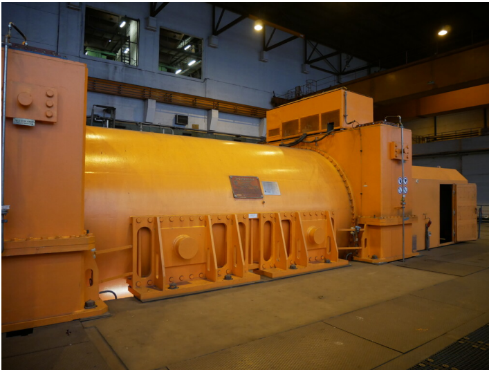
Generatoren Kraftwerk Jänschwalde (2022) Fotograf/Urheber: Kaja Boelcke
