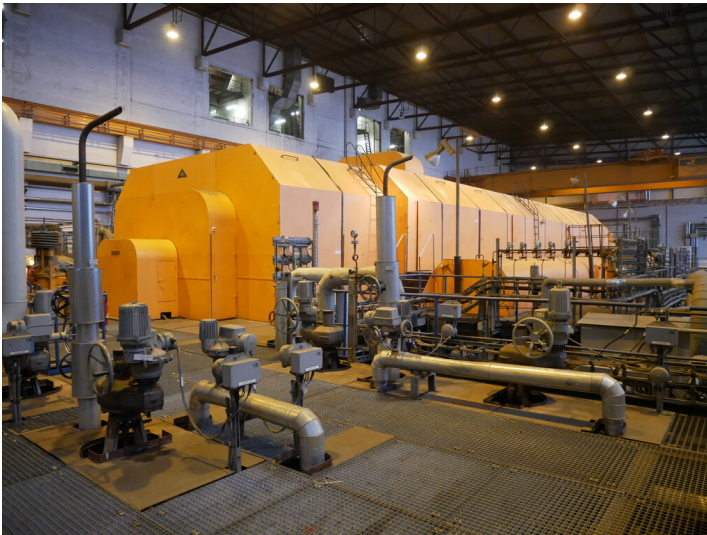
Dampfturbinen Kraftwerk Jänschwalde (2022) Fotograf/Urheber: Kaja Boelcke
