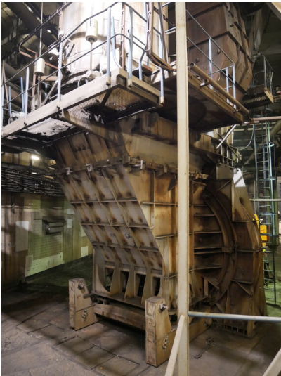
Kohlemühlen Kraftwerk Jämschwalde (2022) Fotograf/Urheber: Kaja Boelcke
