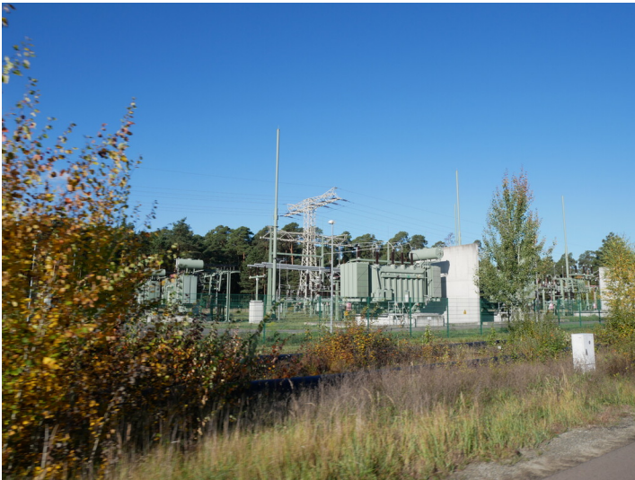
Umspannwerk Radewiese Fotograf/Urheber: Franz Dietzmann
