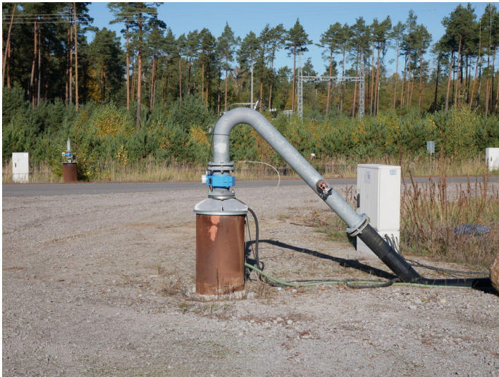
Filterbrunnengalerie Ost Tagebau Jänschwalde Fotograf/Urheber: Franz Dietzmann
