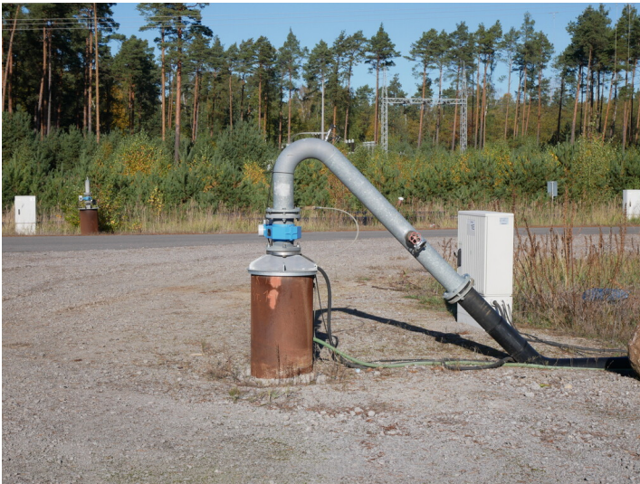
Filterbrunnengalerie Ost Tagebau Jänschwalde Fotograf/Urheber: Franz Dietzmann
