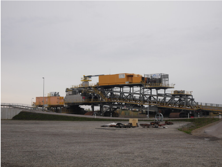
Bandantriebsstationen Neue Kohleverladung Fotograf/Urheber: Tanja Trittel
