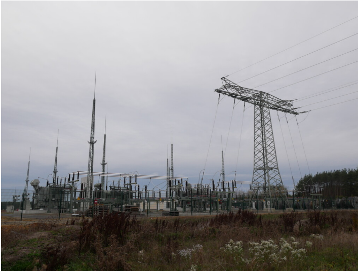
Umspannwerk Terpe Fotograf/Urheber: Tanja Trittel
