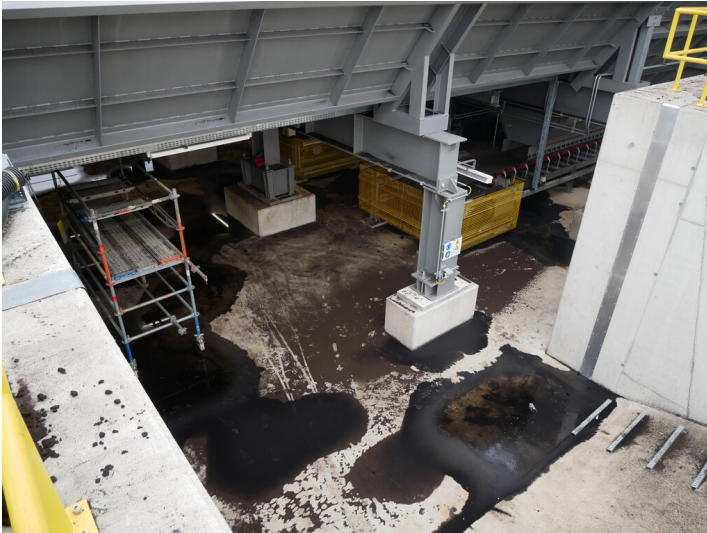
Krümeltgutrückföhranlage Fotograf/Urheber: Tanja Trittel
