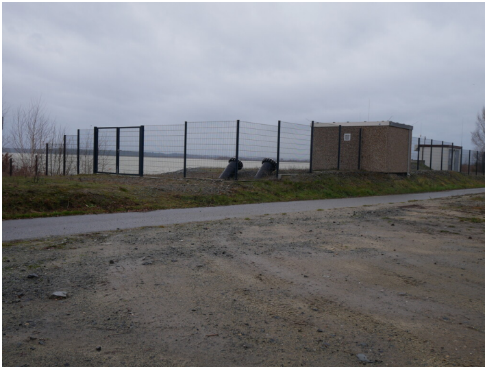
Pumpstation zum Restloch F Fotograf/Urheber: Dr. Barbara Kündiger
