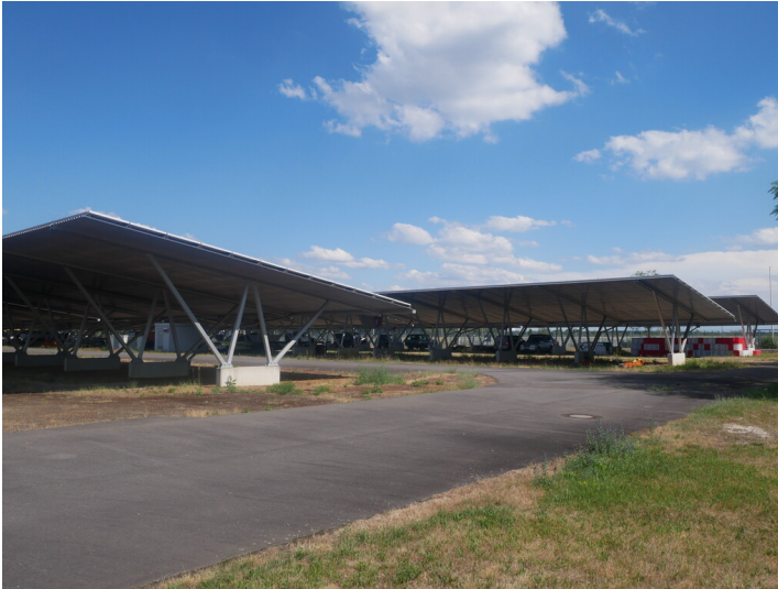
Photovoltaikanlage Lausitzring Fotograf/Urheber: Dr. Barbara Kündiger
