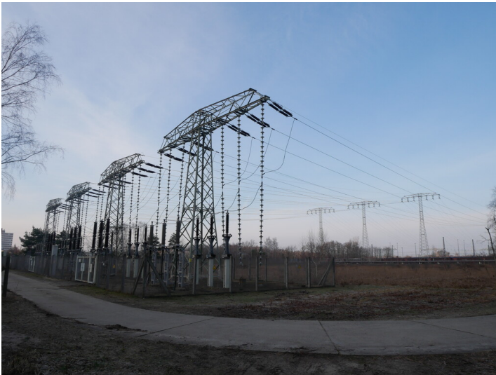
Freiluftschaltanlage Kraftwerk Jänschwalde Fotograf/Urheber: Kaja Boelcke
