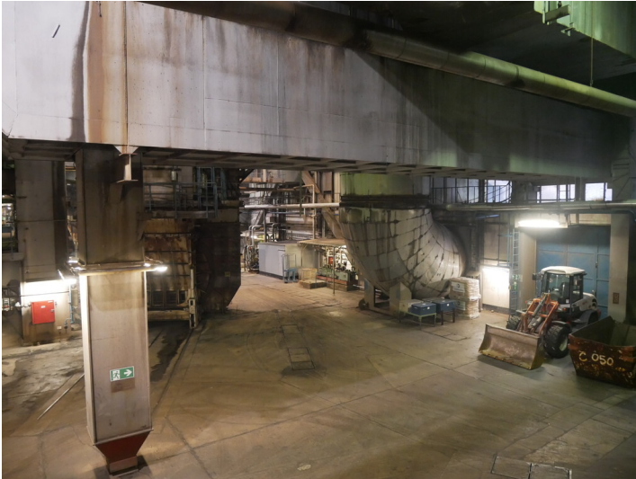
Dampferzeuger Kraftwerk Jänschwalde (2022) Fotograf/Urheber: Kaja Boelcke
