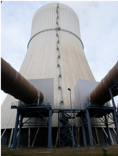
Reingaskanalssystem Fotograf/Urheber: Kaja Boelcke
