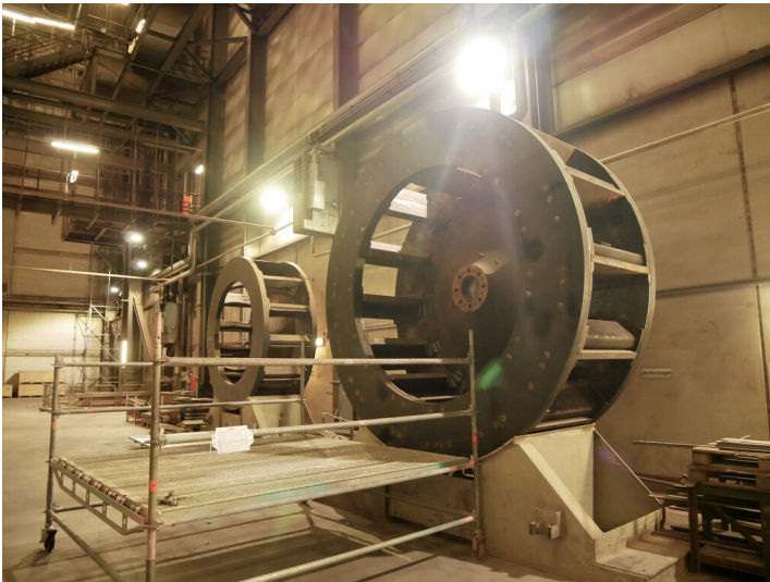
Schlagradmühlen Fotograf/Urheber: Franz Dietzmann
