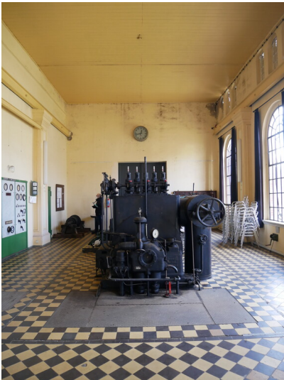
Turbogenerator Fotograf/Urheber: Kaja Boelcke
