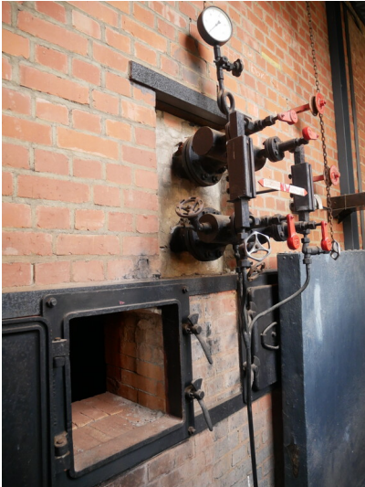
Kessel 1-10 Fotograf/Urheber: Tanja Trittel
