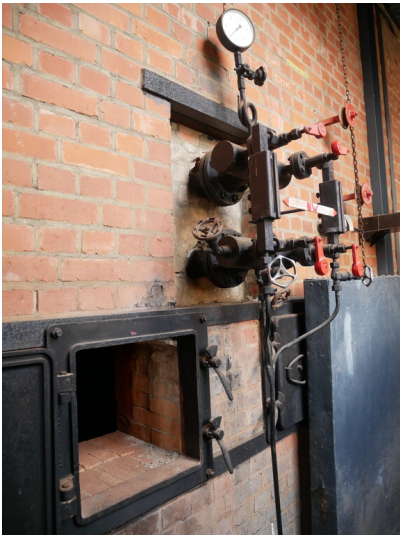
Kessel 1-10 Fotograf/Urheber: Tanja Trittel
