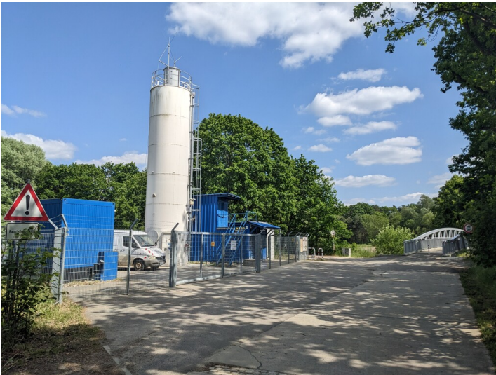
Bekalkungsanlage Spremberg Wilhelmstal Fotograf/Urheber: Franz Dietzmann
