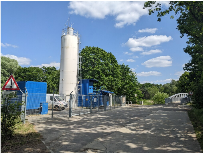
Bekalkungsanlage Spremberg Wilhelmstal Fotograf/Urheber: Franz Dietzmann
