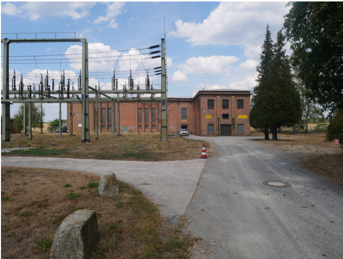
Umspannwerk Großkokerei Lauchhammer Fotograf/Urheber: Stephan Redecker
