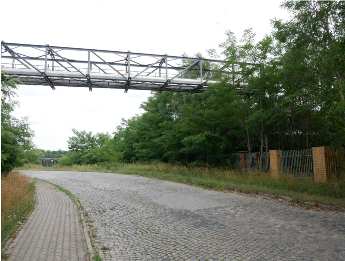
Fernwärmeleitung Lauchhammer Fotograf/Urheber: Kaja Boelcke
