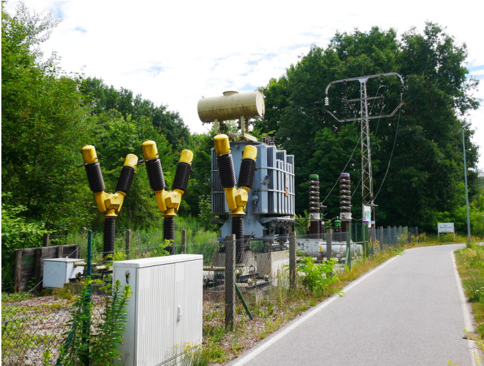
110 kV-Schaltanlage Fotograf/Urheber: Kaja Boelcke
