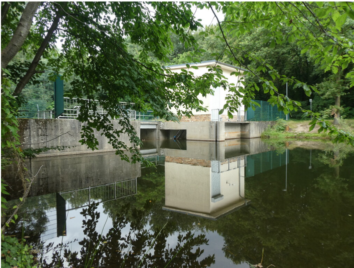
Ableiter Senftenberger See Fotograf/Urheber: Kirsten Krepelin
