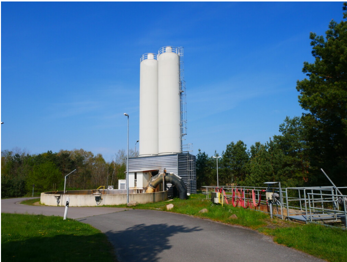
Grubenwasserreinigungsanlage Rainitza Fotograf/Urheber: Franz Dietzmann
