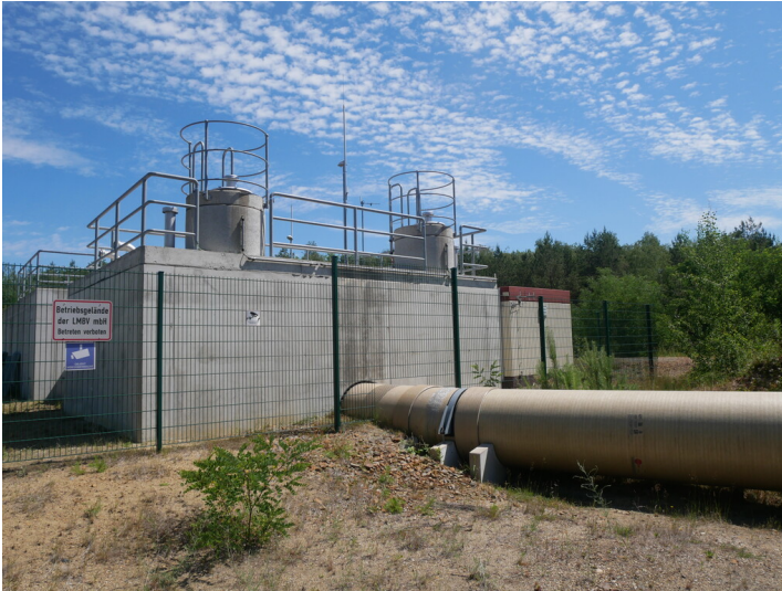
Pumpstation Rainitza Fotograf/Urheber: Dr. Barbara Kündiger
