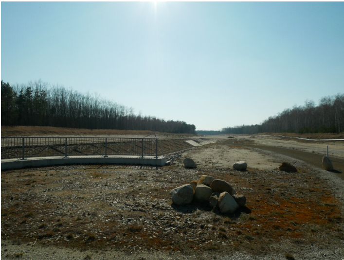
Ableiter Sedlitzer See Fotograf/Urheber: Kirsten Krepelin
