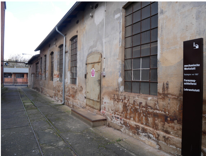
Mechanische Werkstatt der Brikettfabrik Louise Fotograf/Urheber: Kaja Boelcke
