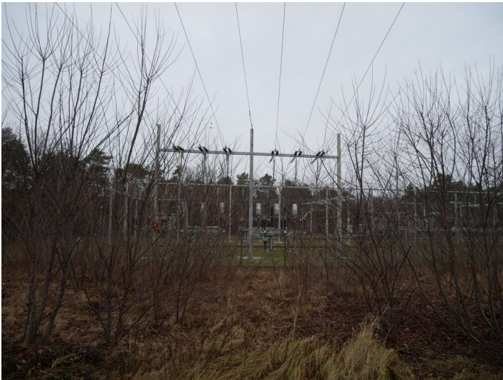
Umspannwerk Cottbus Fotograf/Urheber: Franz Dietzmann
