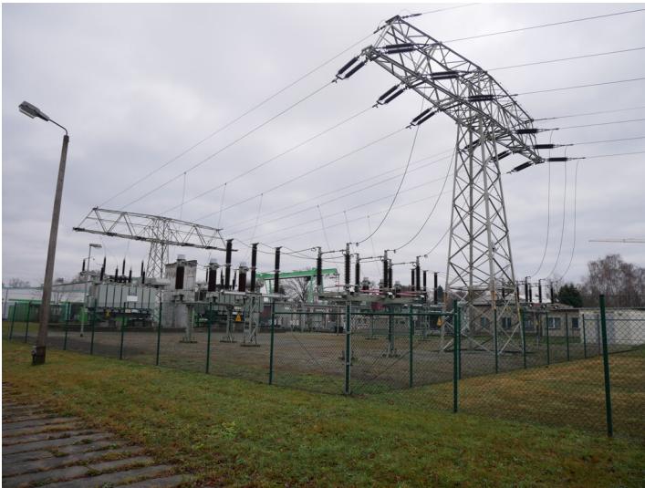
Umspannwerk Forst Fotograf/Urheber: Franz Dietzmann
