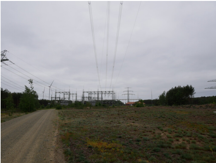
Umspannwerk Altdöbern Fotograf/Urheber: Kirsten Krepelin
