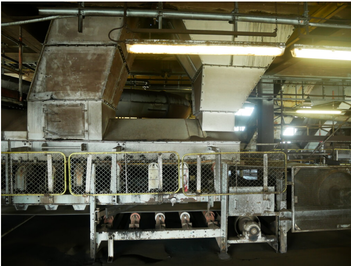
Vorbrecheranlage Fotograf/Urheber: Franz Dietzmann
