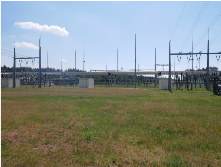
Umspannwerk Großräschen Fotograf/Urheber: Franz Dietzmann
