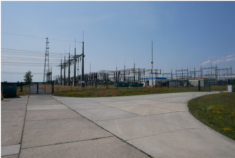
Umspannwerk Ragow Fotograf/Urheber: Franz Dietzmann
