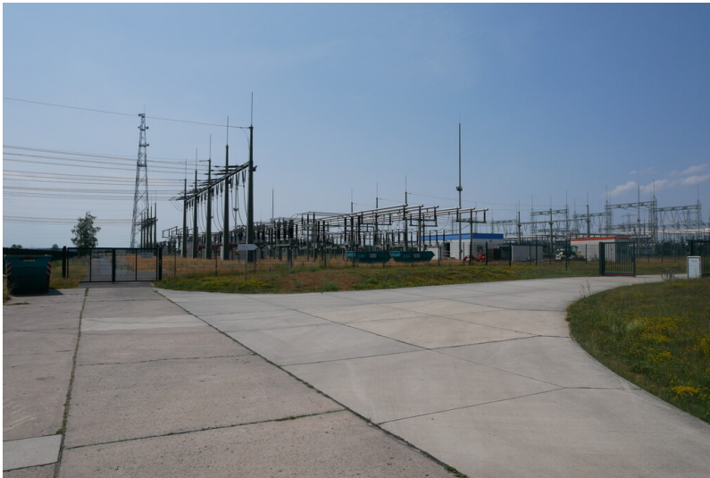
Umspannwerk Ragow Fotograf/Urheber: Franz Dietzmann
