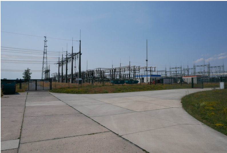
Umspannwerk Ragow Fotograf/Urheber: Franz Dietzmann
