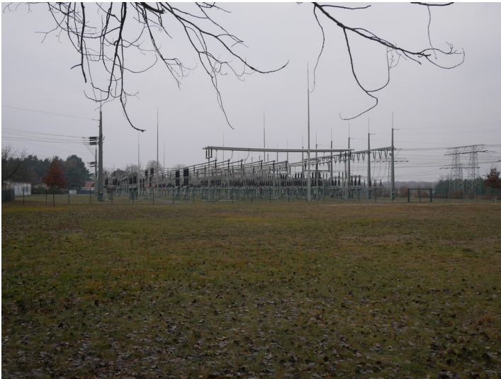
Umspannwerk Neuendorf Fotograf/Urheber: Franz Dietzmann
