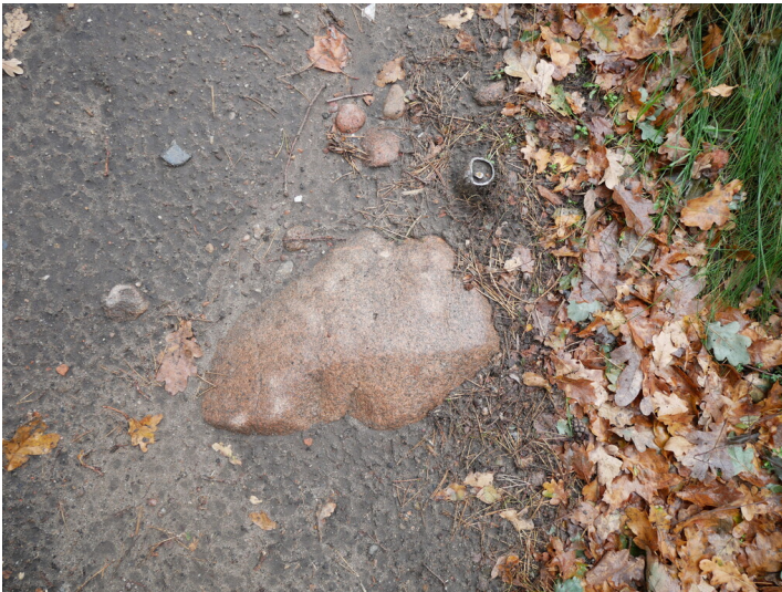
Absperrschieber der Wasserleitung zum ehemaligen Ort Göhrigk Fotograf/Urheber: Franz Dietzmann
